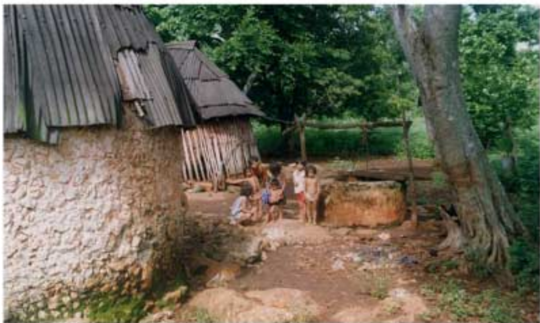
Arriba: casa vernácula. Abajo: casa precaria, el techo de guano ha sido sustituido por lámina de cartón embreado. Cocina derrumbándose.
