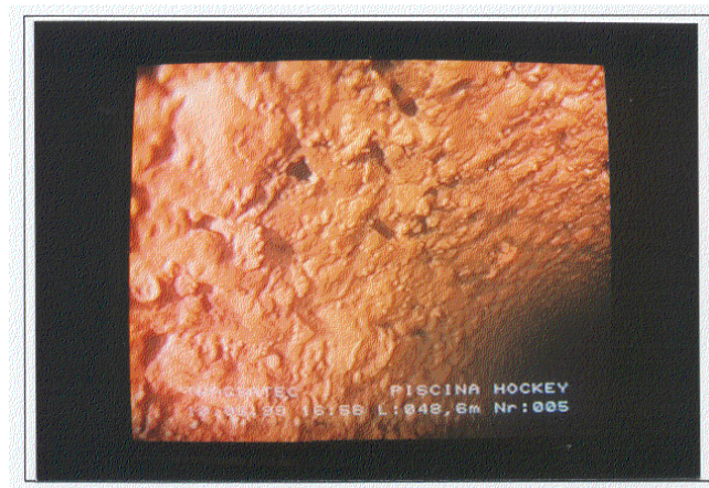
Foto 12.- Rejilla obturada casi por completo. Obsérvese la reducción de los poros filtrantes (foto Tragsatec )
