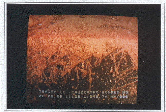
Foto 19.- "Chorreras" ferruginosas. Son concreciones filamentosas débilmente fijadas al entubado (foto Tragsatec )
