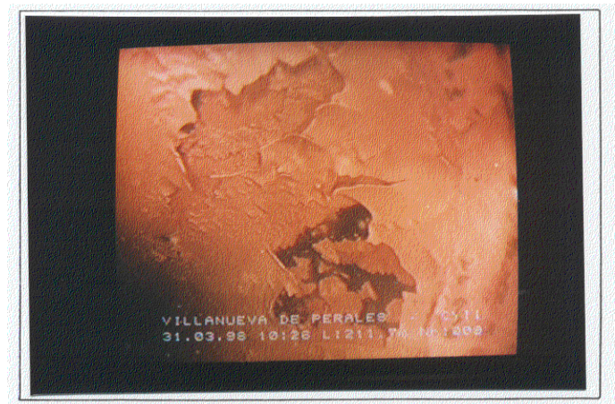
Foto 14.- Efecto de la corrosión sobre tubería ciega (foto Tragsatec )
