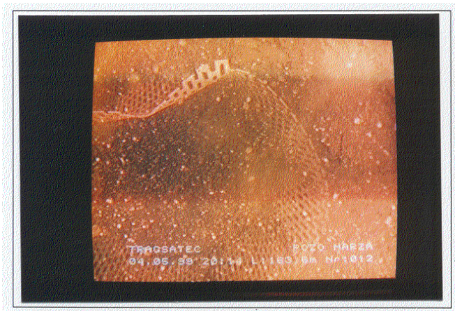
Foto 13.- Efecto de la corrosión sobre un tramo filtrante (foto Tragsatec )
