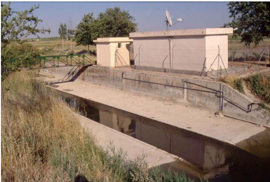
Foto 7.2. Estación de aforos de Villarrubia de los Ojos
