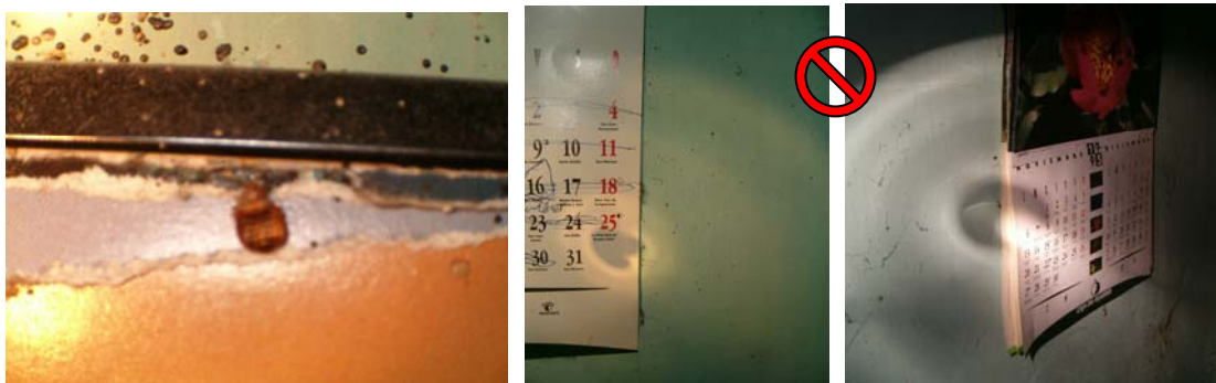
Paramentos en dormitorios infestados. (Fotografías UTCV-Madrid Salud)
