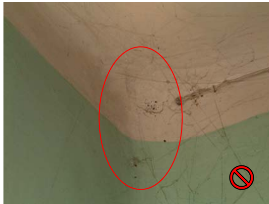
Techos; suciedad e insectos. (Fotografía UTCV-Madrid Salud)
