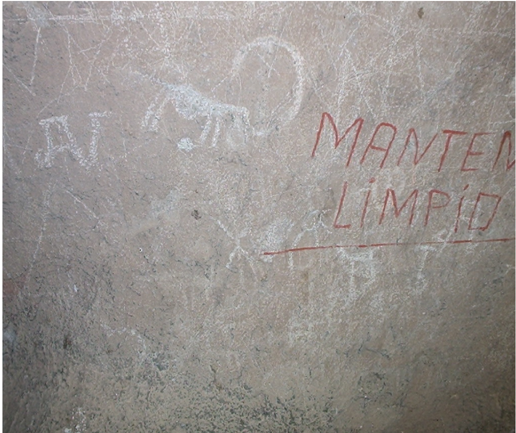
Panel con pinturas dañadas por la acción humana. El Honguito- La Playa
