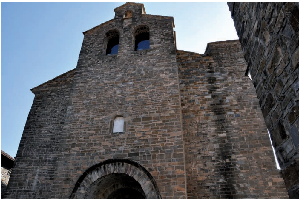
Fig. 11. San Pedro de Siresa. Parte superior de la fachada occidental donde se aprecian las reconstrucciones murales
