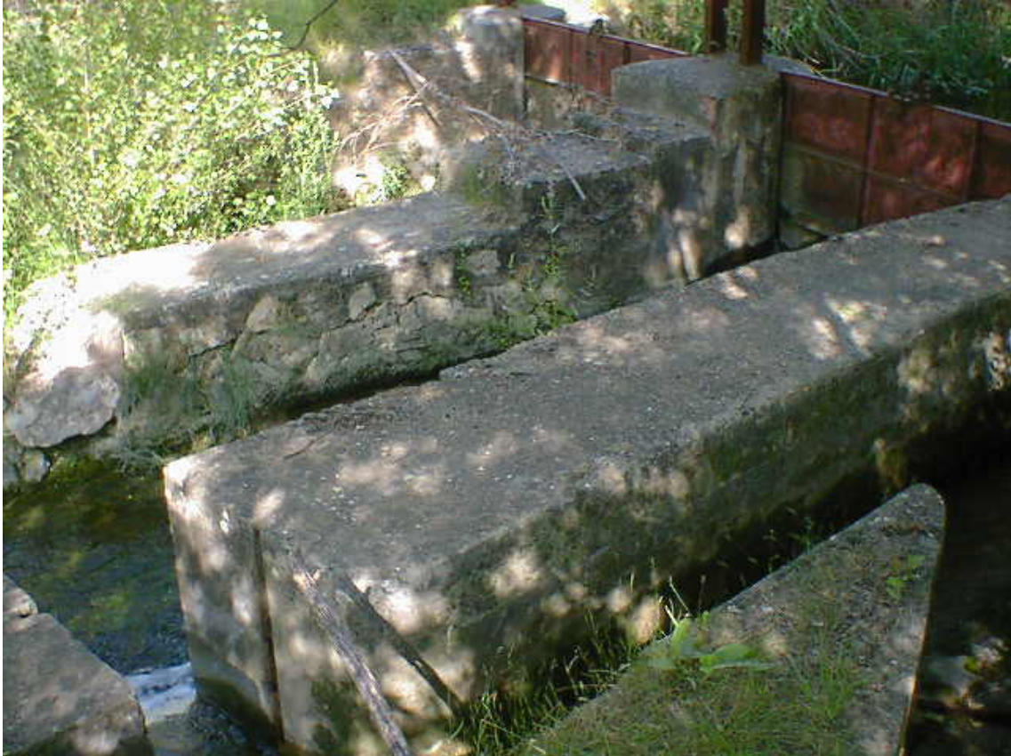
Fig 43. Toma de agua de Perohumos.
